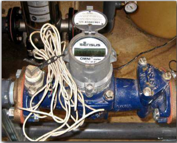
AE - 11 Flow Meter
