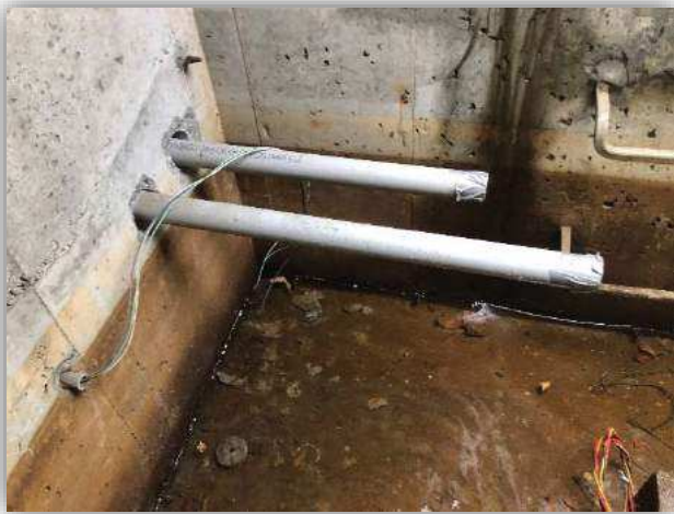
AE- 118 Conduit lines
